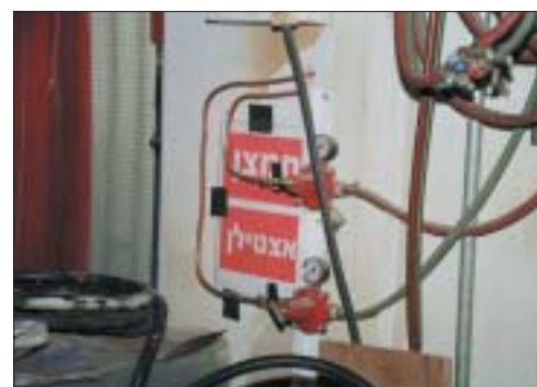
מיכלי האצטילן והחמצן, המשמשים בריתוך, מוצבים מחוץ לאולם העבודה. הגזים מגיעים לעמדת העבודה באמצעות צנרת קבועה העוברת דרך הקיר ומסתיימת בברזים ומפחיתי לחץ שמיקומם נגיש ונוח להפעלה ולצפייה
