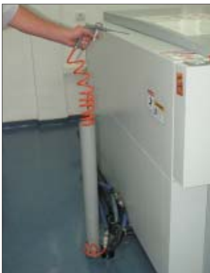
צינור האוויר הדחוס (מסולסל, אדום) מוגן מפני פגיעות באמצעות מוביל קשיח, המשמש גם לאחסנת הצינור הארוך כשאיננו בשימוש
