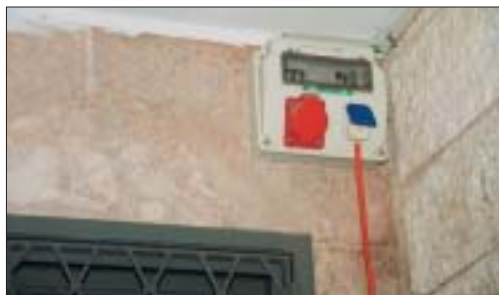
קופסת הזנה לאספקת כוח לעבודות בחצר הקמפוס מוגנת מפני רטיבות ומצוידת במבטחים. כבל ההזנה לצידו החשמלי מוגן בשרוול שקוף
