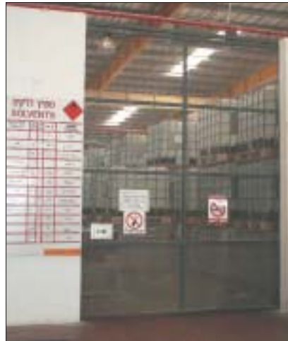
פתח "מפרץ דליקים" (מעל לדלת הרשת מותקן תוחת קצף)
