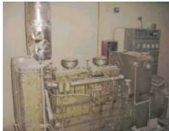
איור מס' 5 גנרטור קבוע בתוך חדר
