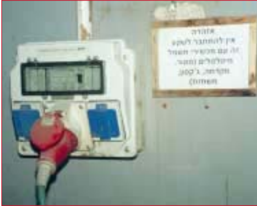
לוח זה איננו מחובר דרך מפסק מגן לזרם דלף (מימסר פחת) ולפיכך - אסור לחבר אליו כלים מיטלטלים
