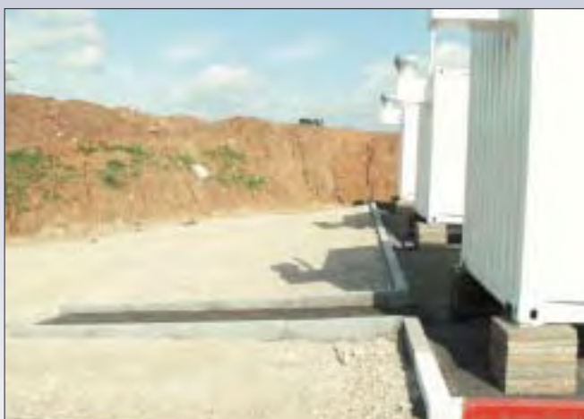
אתר לפינוי חומ"ס בשעת חירום: שיפוע לשליטה על שפך, המכוון לאזור אצירה, למניעת פיזור מסוכן
