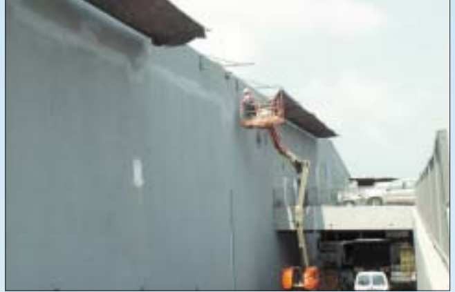
הרכבת הרשת אל מסגרת זיזית נעשית מתוך במת עבודה ניידת. העובד מוגן מפני נפילה מגובה ע"י אמצעי קשירה המחובר אל מסגרת התא
