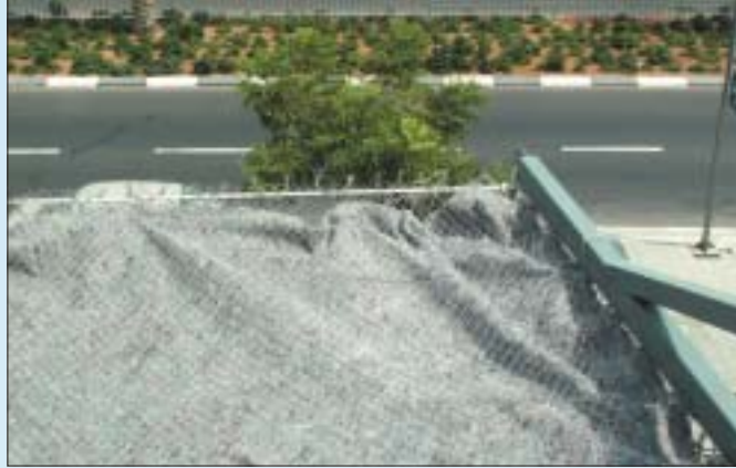
רשת ביטחון תלת-שכבתית מורכבת מרשת ראשית (עמידה לעומס), רשת משנית דקה וצפופה (עמידה בפני נפילת אבנים/חפצים קטנים) ובד תרמי (מגן על הרשת מקרינה ועמיד לנפילת חול וחפצים זעירים)
