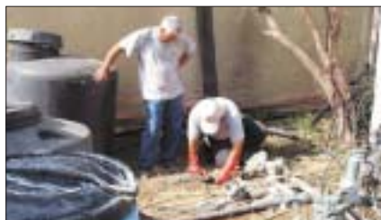
פירוק קו הספקת המים ממערכת המים הקבועה, לצורך חיבור ההספקה למיכל הזמני שהובא למקום
