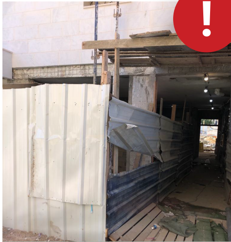
جدار بحاله غير سليمه في موقع البناء
