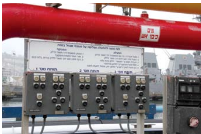
לוח הפעלה מרוחק של תוחתי מים וקצף במזח הדלק של תש"ן בנמל חיפה
